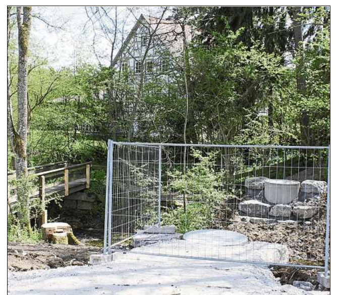
Die alte Brücke zur Kutzmühle ist noch da, die Fundamente daneben sind schon gebaut. Foto: Müller
